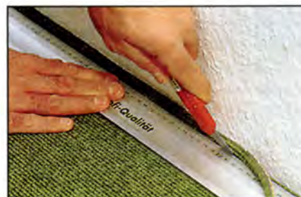
Излишки ковровина обрезают ножом так, чтобы покрытие лежало свободно и не упиралось краями в стены. Между стеной и покрытием необходимо оставить небольшой зазор.
