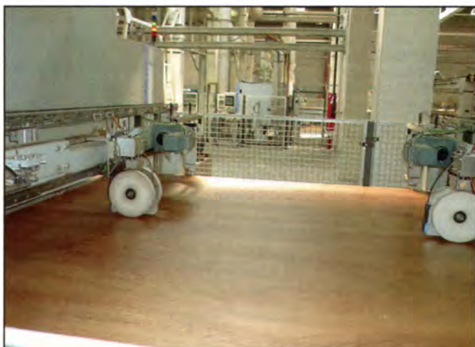
Линия раскроя плит на ламинатные доски в соответствии с заданными размерами.
